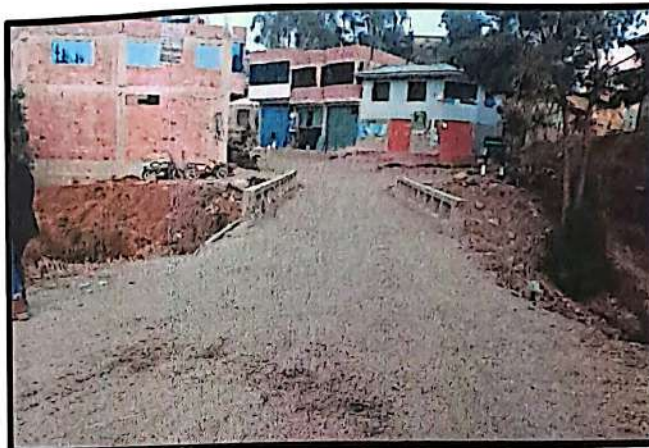
FOTO N° 02: En la actualidad el puente se encuentra en mal estado de conservación sin señalización existente.
